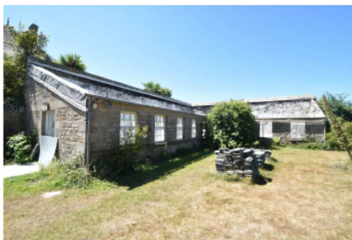
Réserve après l'incendie
