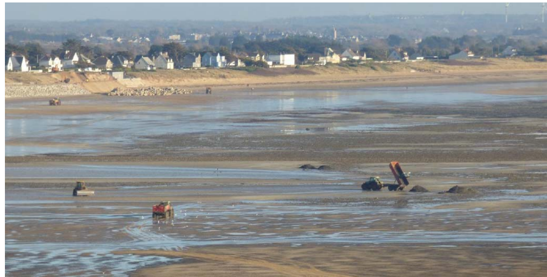
Figure 20 : Déchargement de tracto-bennes sur l'estran de la plage de Barneville dans le cadre des opérations de dragage d'entretien du chenal (IDRA, 2017)
