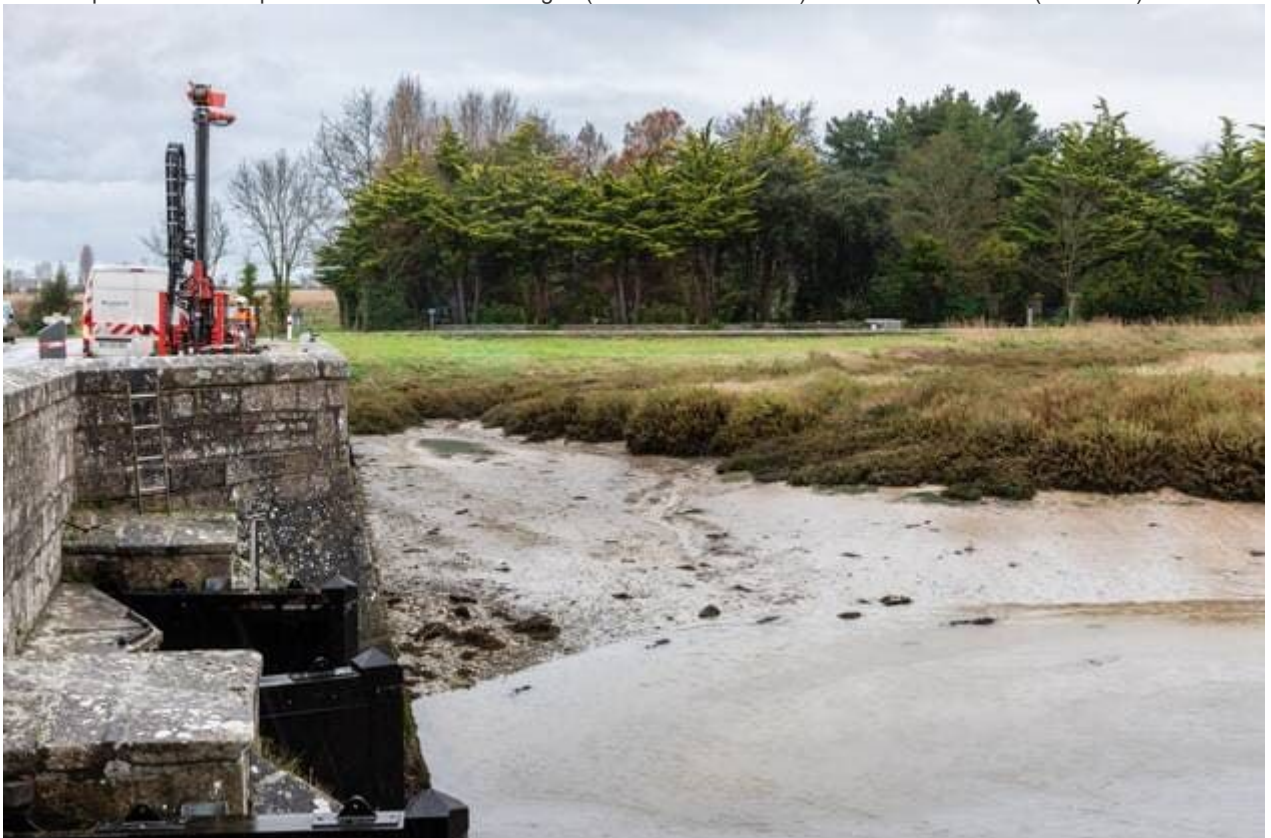
À Saint-Vaast, la prévention des risques de submersion nécessitera environ 4 millions d'euros de travaux, estime la collectivité. | THIERRY HOUYEL/LE COTENTIN
