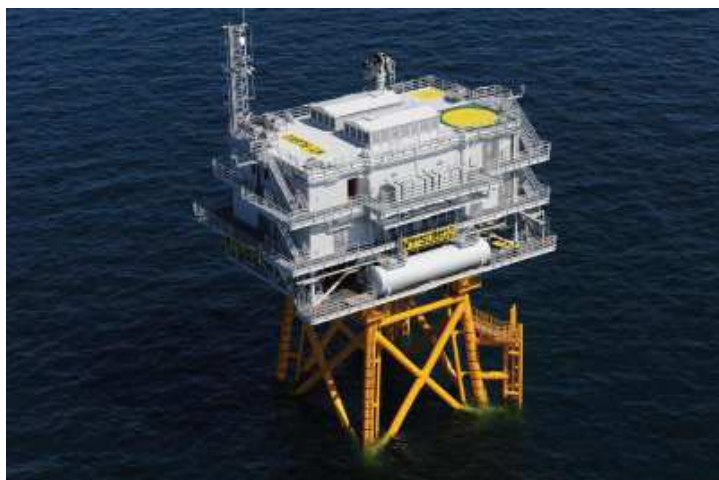
Figure 4 : Poste électrique en mer du parc éolien de Walney, fourni à titre d'illustration (source : étude d'impact)
